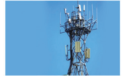
sistema de telecomunicaciones
