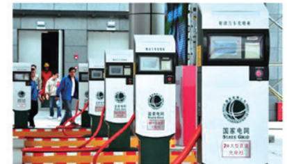
cargador para vehículos eléctricos
